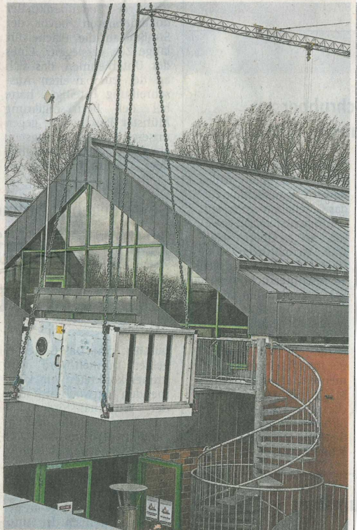
Mit dem Autokran wurden die Bauteile für die neue Lüftungsanlage im düb „eingeflogen“.
